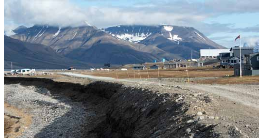
Deler av veien har rast på sjøen og en ny trasé må lages. Flere meter land kan bli tatt av et uvær som står rett på i løpet av kort tid. Det er mulig å gå i fjæra til Vestpynten på lavvann.
